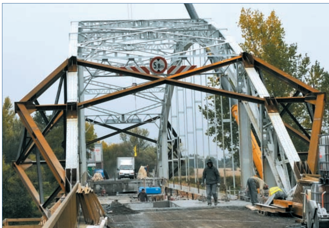
11. kép: Az ívstabilizáló acél keretszerkezet 3D váza a megvalósulva (a rácsos pót-végkereszttartó ebben a fázisban még nem épült meg)
